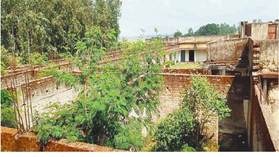
खण्डहर में तब्दील निर्माणाधीन स्कूल भवन।
